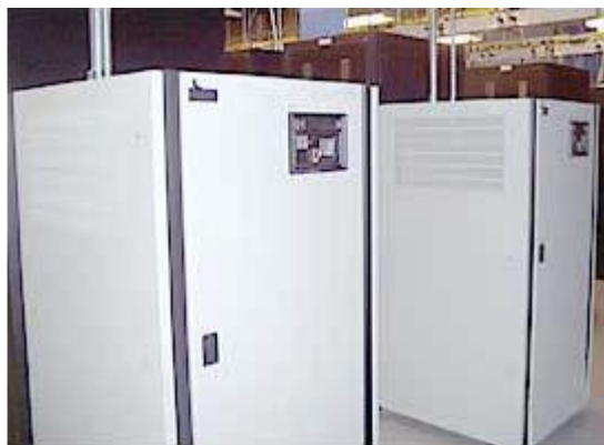
Exemplo de equipamento para tolerância a falhas ( datacenter UPS ).
